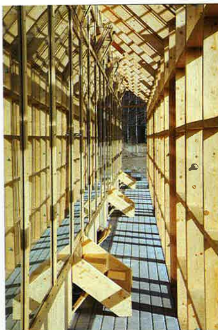
Po celé délce jižního průčelí probíhá předřazená zimní zahrada, která plní především roli pasivního slunečního kolektoru.
